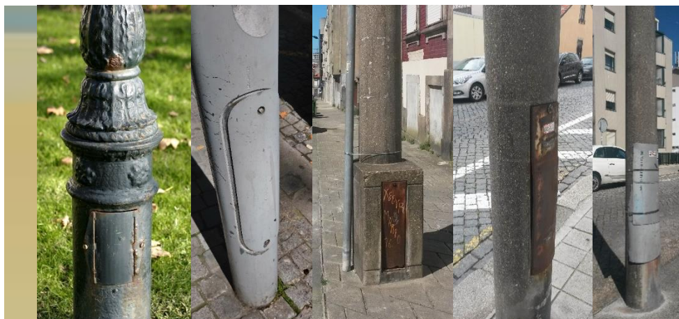
Figura 24 - Degradação de Algumas Portinholas existentes na Cidade
